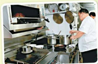
■全電能廚房既可保障員工和院友安全，又能令空氣更清新。
